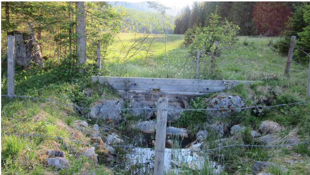
Abbildung 27: In die Jahre gekommene Sperre an einem Entwässerungsgraben am Rande des Heilbrunner Moors (Aufnahme am 27.05.2017)
