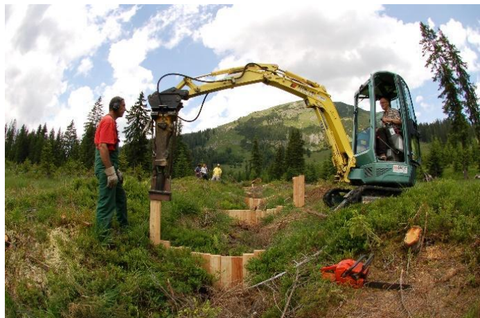
Abbildung 7: Im Zuge der Renaturierungsarbeiten wurden Lärchenholz-Dämme errichtet, um die Moore wieder zu vernässen. Foto: Günter Haselwanter
